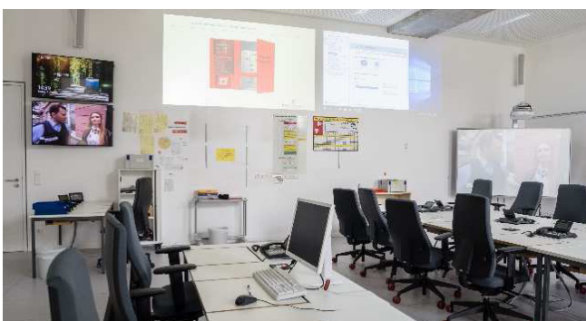
Stabsraum: Projektoren, Bildschirme, Lautsprecher sowie Tischanschlussfelder für digitale und analoge AV-Signale
